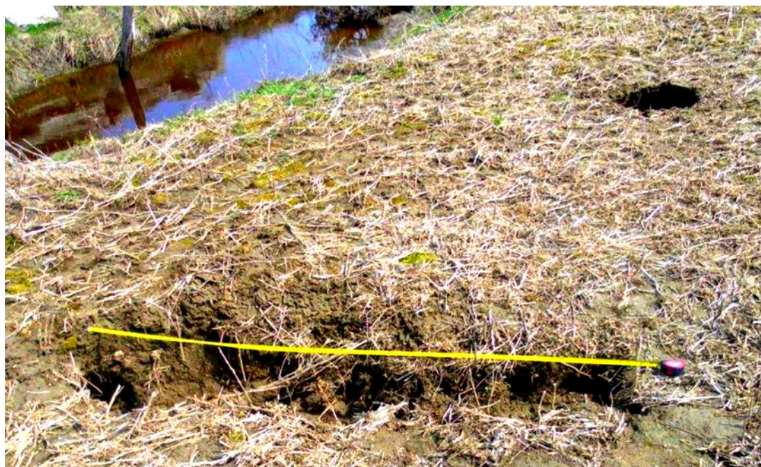
Figure 30. Érosion en tunnel.
