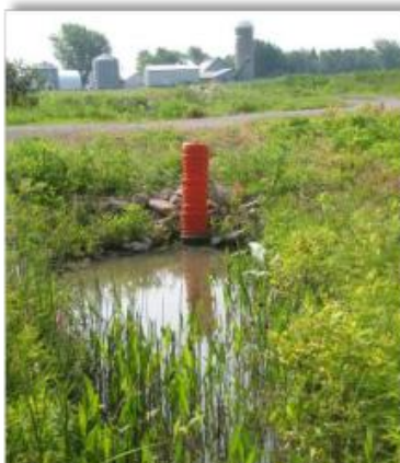
Fossé-avaloir adapté pour la faune.
