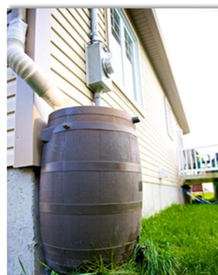
Exemple d'installation d'un baril pour la récupération des eaux pluviales
